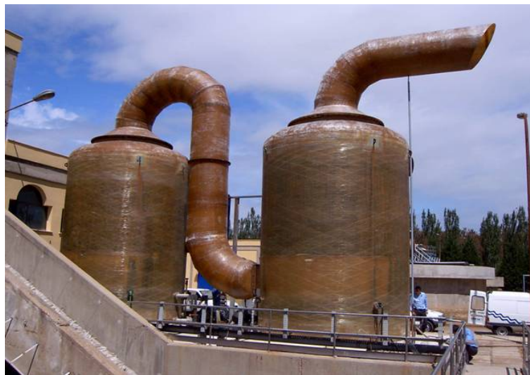
Figura 2. Instalaciones de desodorización en una EDAR
