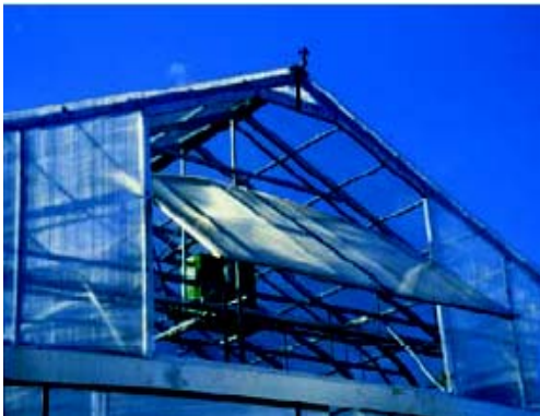
Figura 3. Trampillas de ventilación
